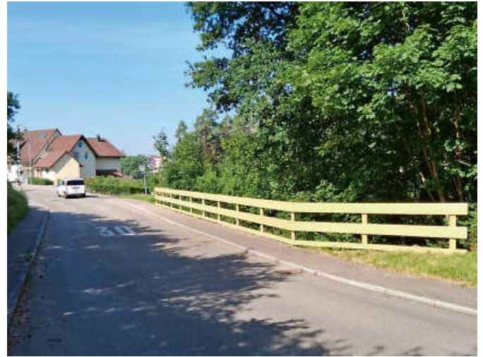
Der Fußweg neben der Krapfenreuter Straße am Ebersbacher Ortseingang ist jetzt wieder bestens gesichert.
