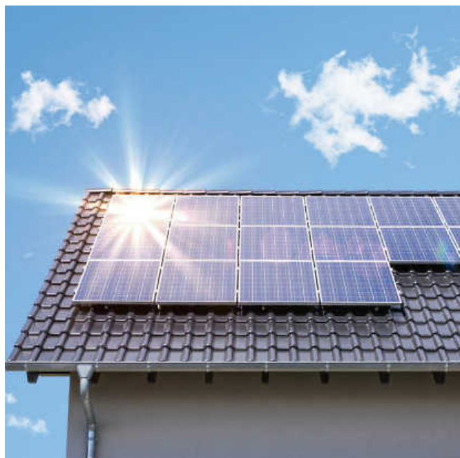
Gemeinsam mit der Gemeinde Hochdorf und den Teckwerken plant die Stadt Ebersbach an der Fils eine Photovoltaik Bündelaktion.
